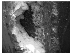
图 1 水从钢管端面渗入造成的钢管腐蚀
