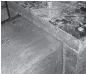
图 7 安装阻尼器后轨枕挤出状况
