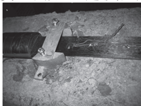
图 4 锚固端混凝土压酥
