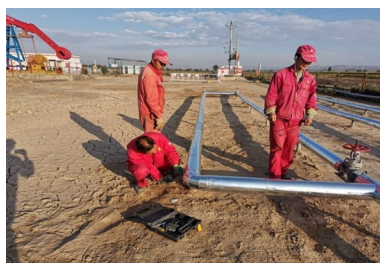
图2 现场垢样取样
